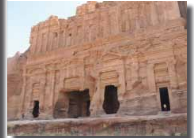
Fassaden an exponierten Stellen sind verwittert - wie die des Palastgrabes
